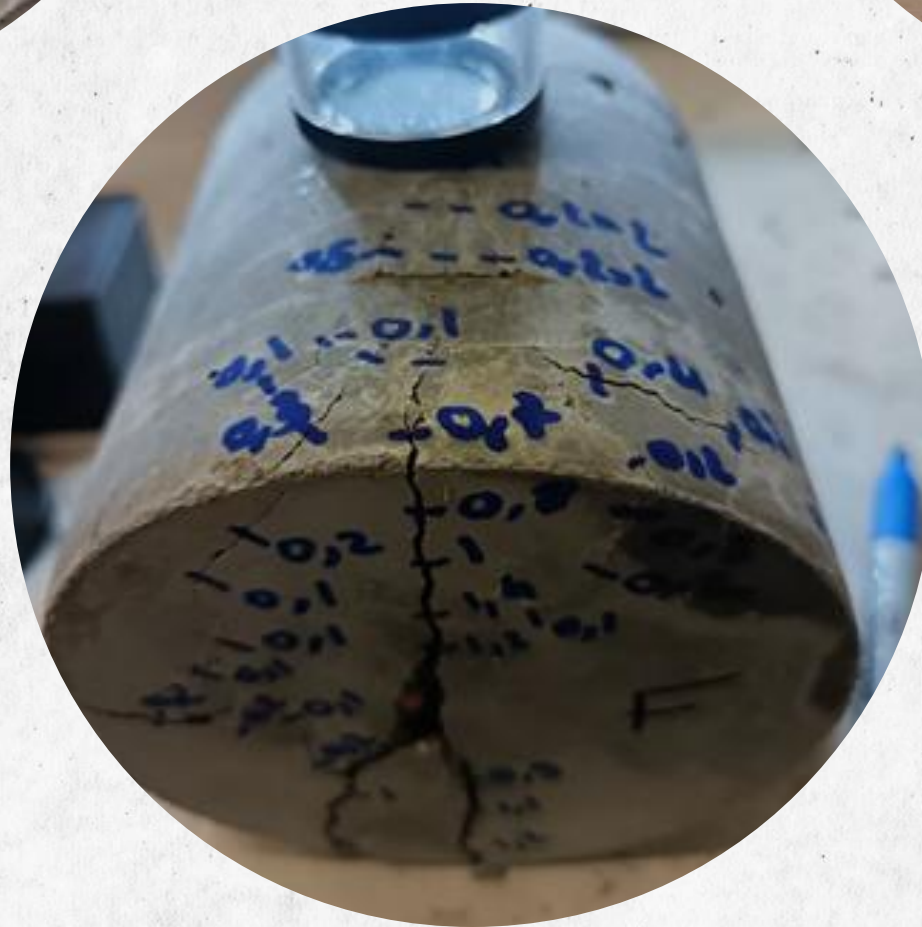
Mesure des fissures
